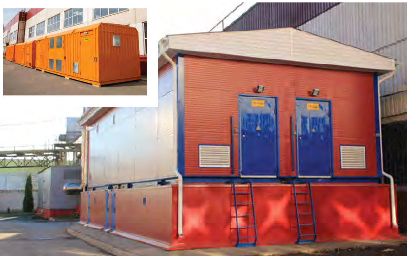
Комплектная трансформаторная подстанция в блок-контейнере
