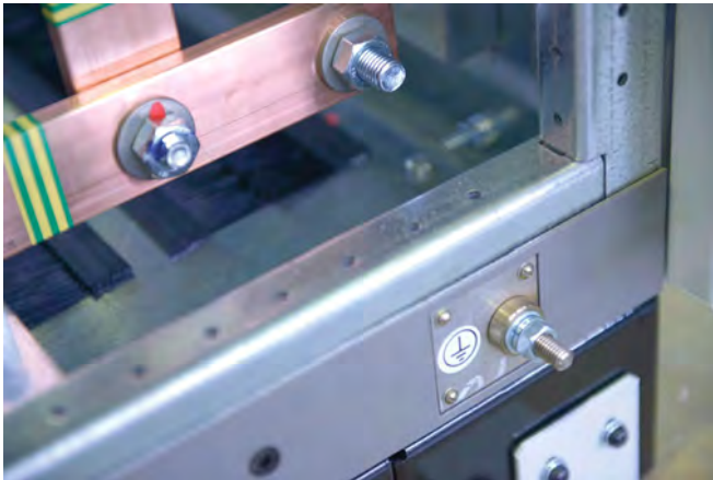
Узел, позволяющий выполнять видимое заземление
