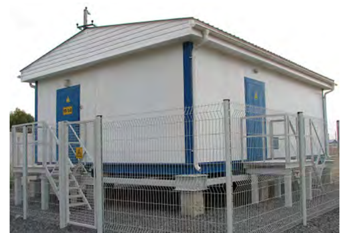
Комплектная трансформаторная подстанция в блок-контейнере
