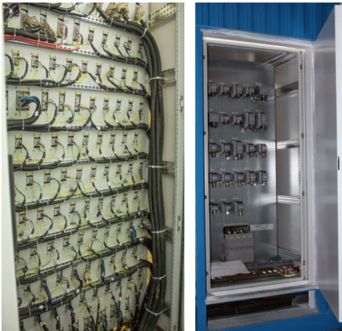
Рисунок 1 – шкаф управления насосами
