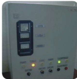
Шкаф управления возбуждением генератора ШУВГм-5.1 по ТУ 3433-011-12261711-2004
